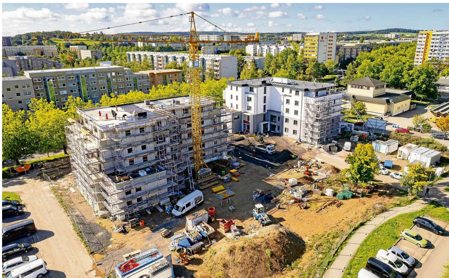
Drohnenaufnahme vom Weiden-Carré in Gera-Lusan. Es ist das derzeit größte Investitionsprojekt der WBG „Glück Auf“ Gera.
