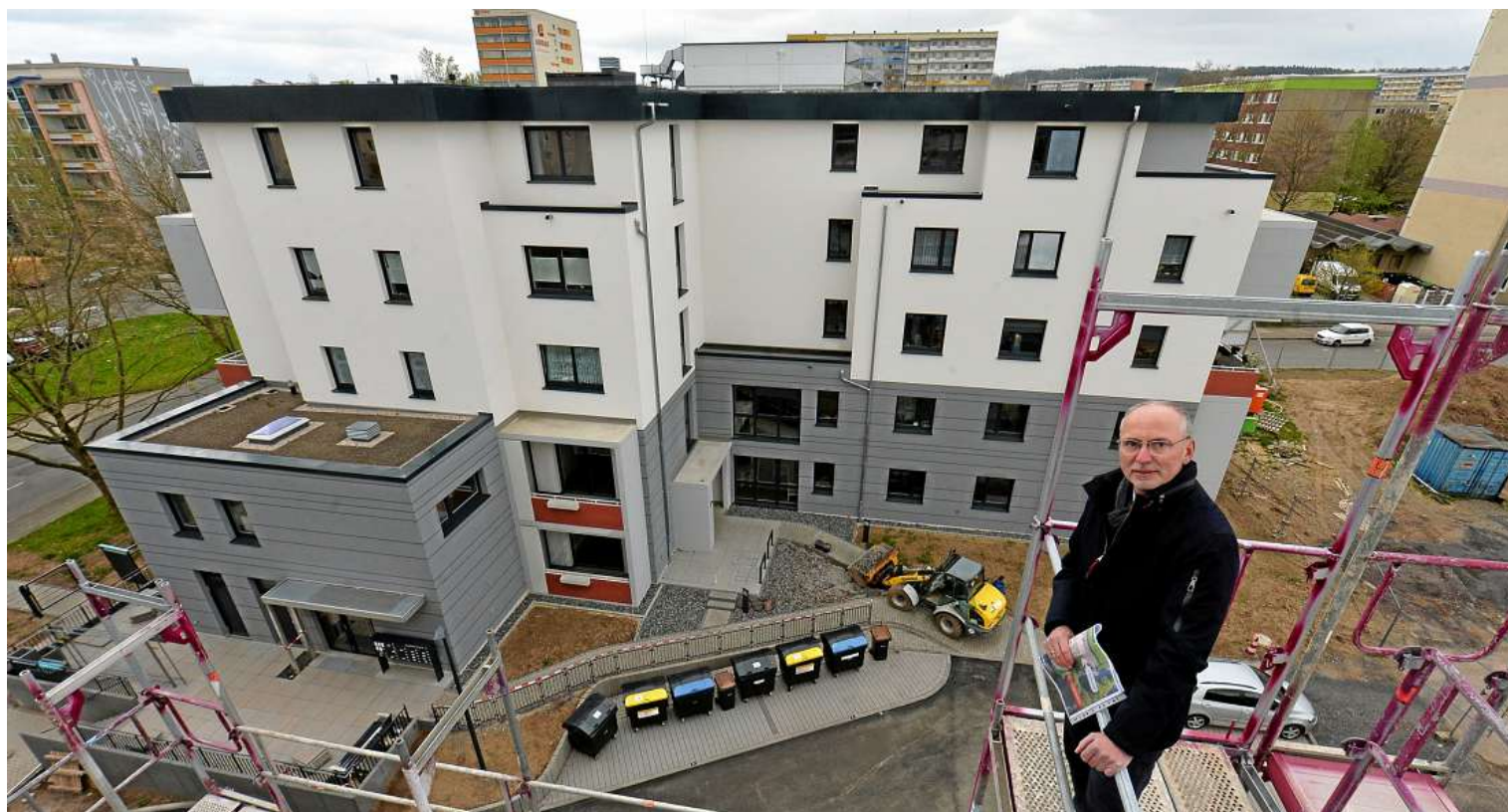
Vorstand Uwe Klinger auf der Baustelle Weiden-Carré. Im Hintergrund das bereits fertiggestellte Haus Nummer 1.
