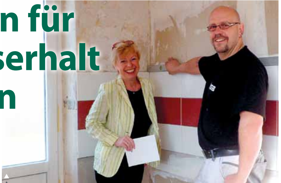
▲ GWG-Vorstand Kerstin Jobst-Dalibor bei einer Wohnungsinstandsetzung in der Uhlstraße. Fliesenleger Mike Bär verlegt einen modernen Fliesenspiegel in der Küche.
