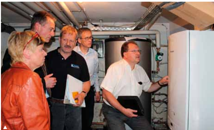
▲ Kerstin Jobst-Dalibor und Uwe Klinger von der „Glück Auf“, Klempnermeister Gerd Riedel und die Vertreter der Firma Junkers, Wolf-Dietrich Hasse und Andreas Franz, (v.r.) vor einer der acht neuen Heizungsanlagen in der Sommerbadstraße
