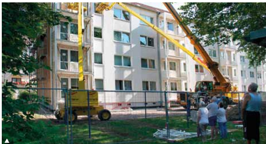
▲ Die Demontage der alten Balkontürme war auch für die Anwohner ein nicht alltägliches Ereignis, sie verfolgten aufmerksam die Abrissarbeiten.
