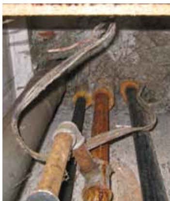
Alte verrostete Bestandsleitungen sowie marode Deckenverschlüge ohne Brandschutzanforderungen – der Zustand der Installationsschächte vor der Strangsanierung.
