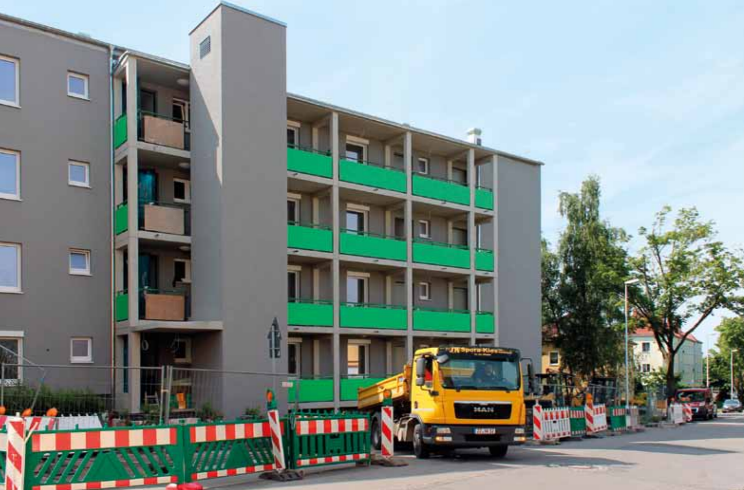
Laasener Straße 106, das erste Wohnhaus, welches schon während der Geschäftsbesorgung durch die „Glück Auf“ komplett saniert wurde
