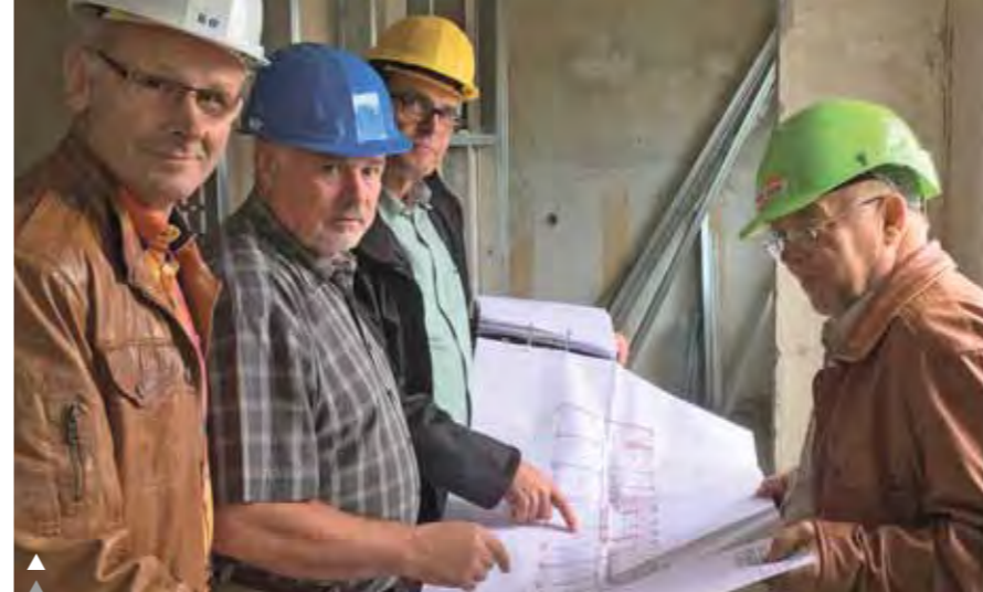
▶ Bauleiter Olaf Kalläne (3.v.l.) informiert Aufsichtsratsmitglieder über den Baufortschritt in der Niemöllerstraße
