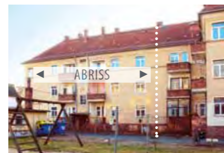
Von Hinten wird der schlechte Gebäudezustand sichtbar
