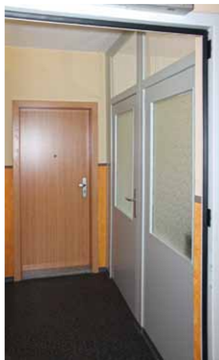
Für die Loggien in Hochhäusern gelten neue Brandschutzbestimmungen
