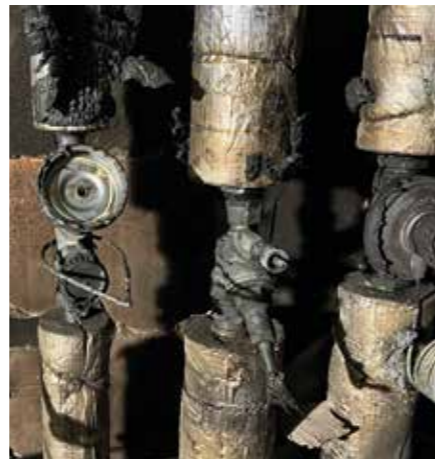
Neben einer Rußschicht, die sich im gesamten Keller- und Treppenhausbereich absetzte, wurden auch die Versorgungsleitungen durch das Feuer zerstört.
